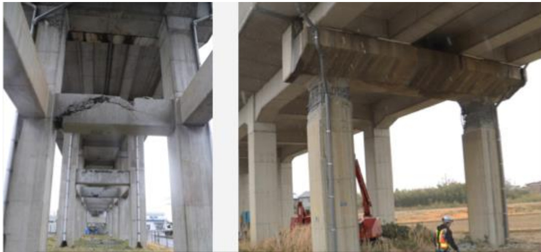
2022年福島地震對新幹線結構造成損壞
