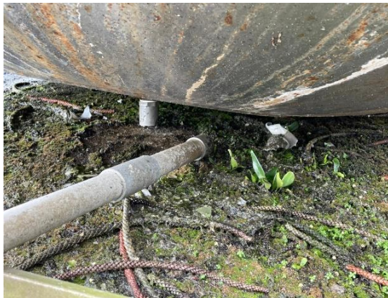
水塔傾斜、水管破裂
