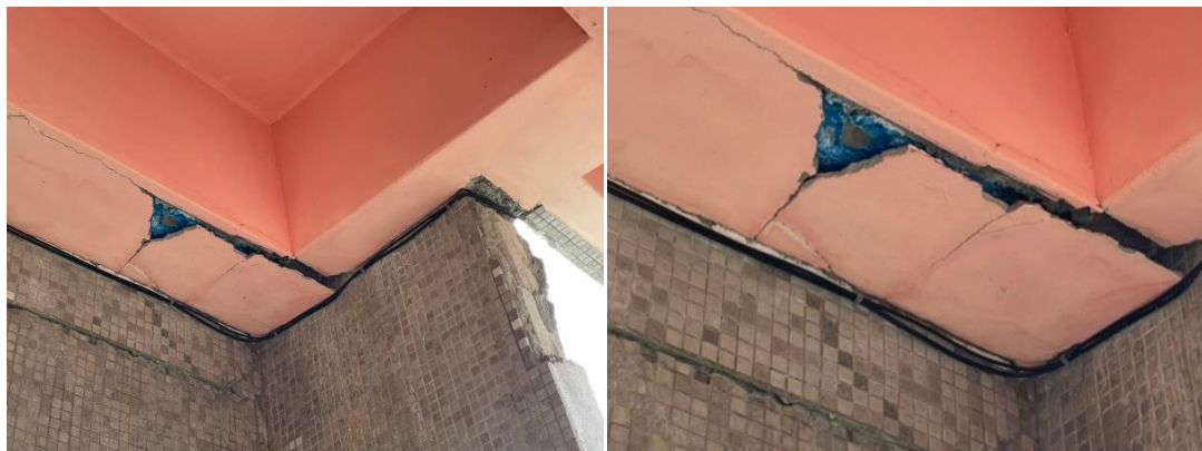
教學大樓與廚房廊道的樑柱裂縫
