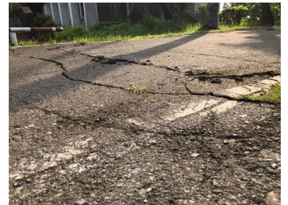
學校東面柏油通道出現裂縫
