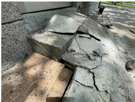
教師宿舍走道損裂
