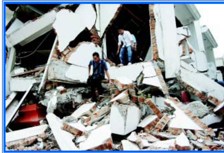
倒塌的學校建築(路透)
